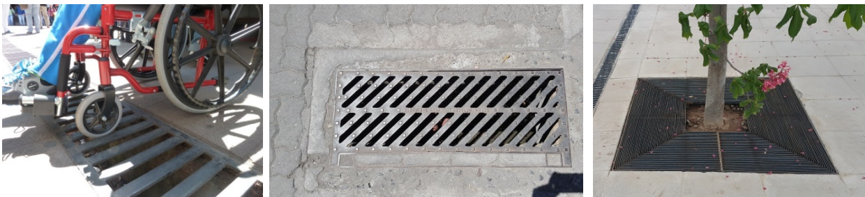
Foto 15 (izq): Rejillas dispuestas peligrosamente a favor de la circulación peatonal pudiendo causar atascos de las ruedas.
