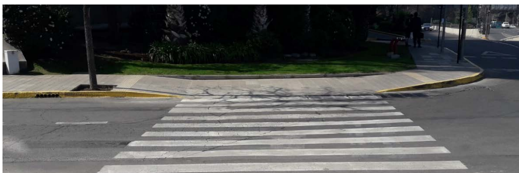
Foto 10: Cruce peatonal rebajado en todo su ancho hasta igualar la altura con la calzada
