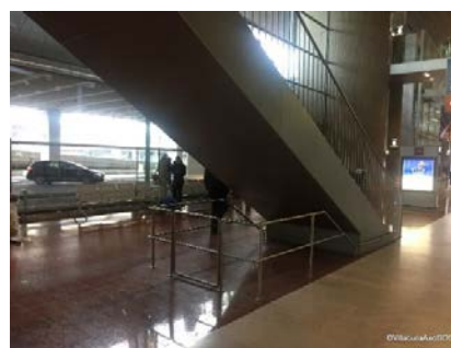
Foto 51: Protección bajo el área de escalera donde podría ingresar una persona ciega y golpearse.
